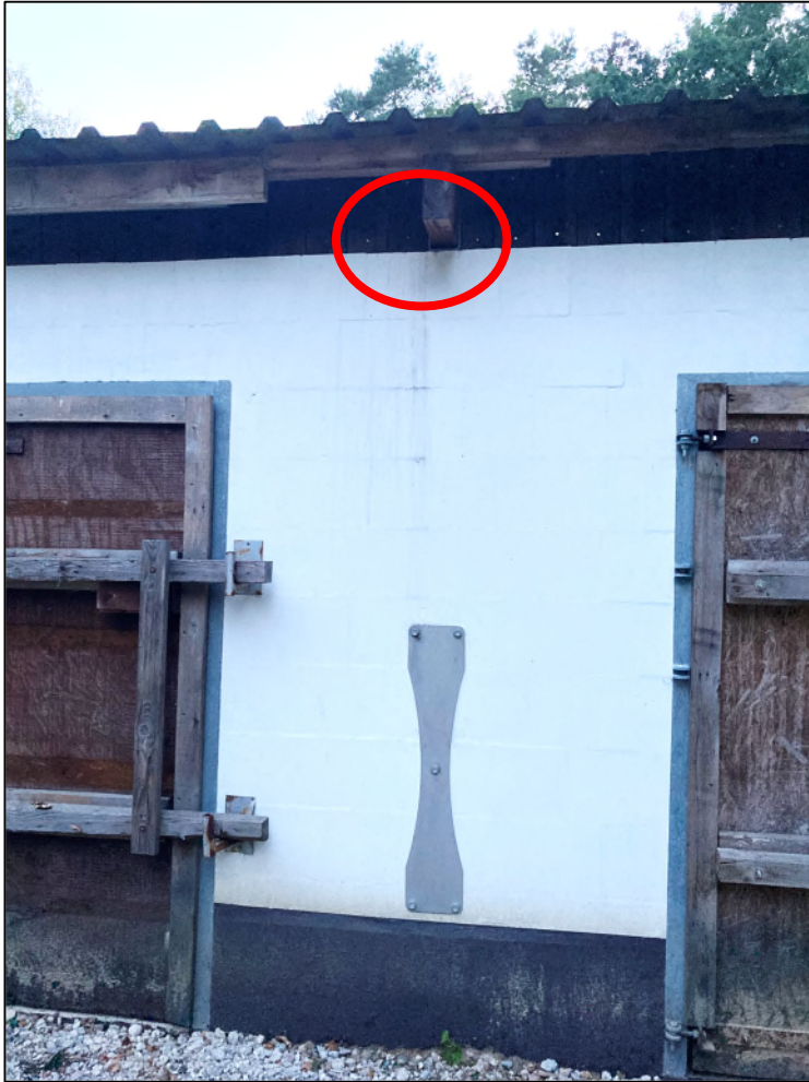
Abbildung 25: Zwergfledermausquartier am Pferdestall, außen erkennbar am Kotstreifen.
